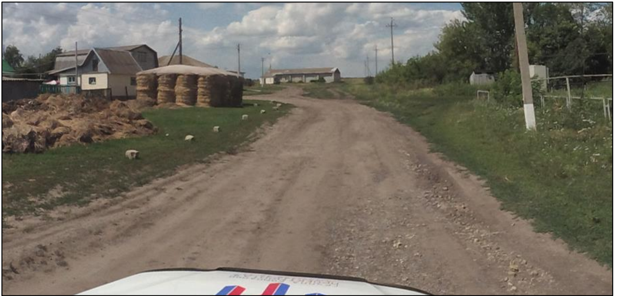
Рисунок 1.3.31– Состояние дорожного покрытия ул. Молодежная, с. Крутояр на момент обследования
