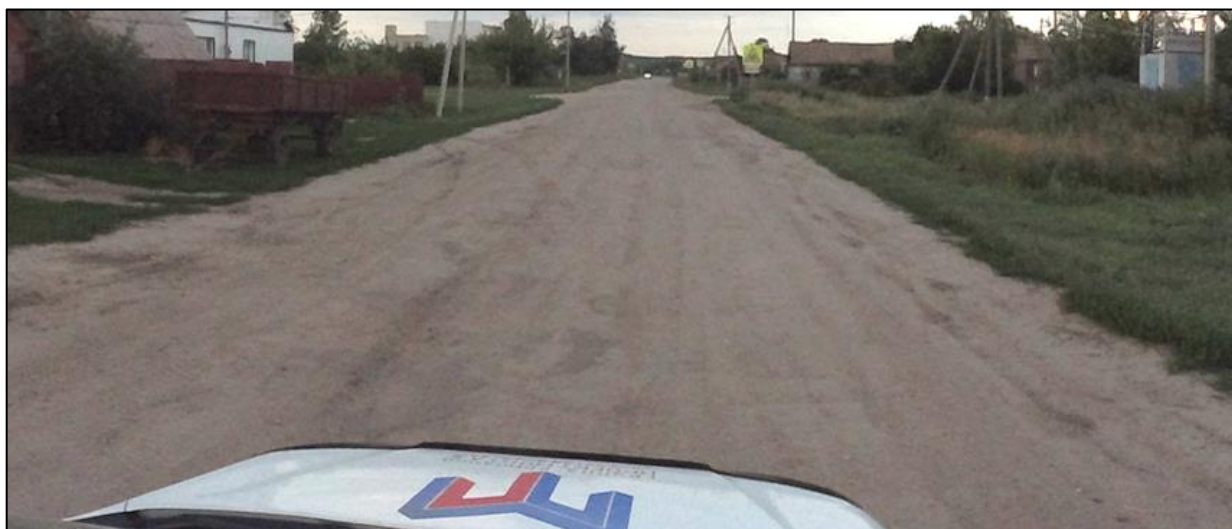
Рисунок 1.3.15 – Состояние дорожного покрытия ул. Крупской, с. Бакуры на момент обследования
