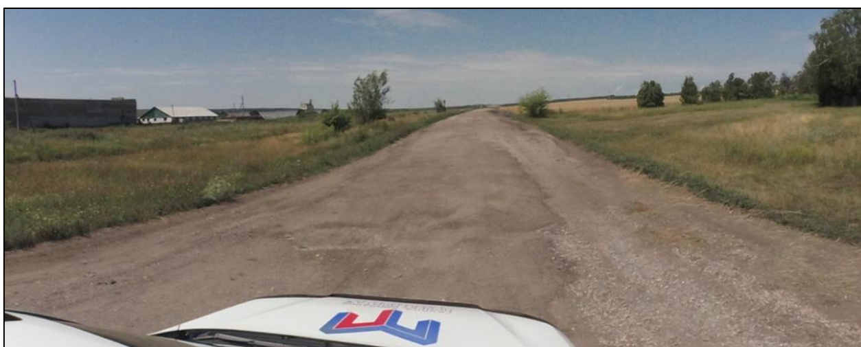
Рисунок 1.3.16 – Состояние дорожного покрытия ул. П. Орешина, с. Галахово на момент обследования
