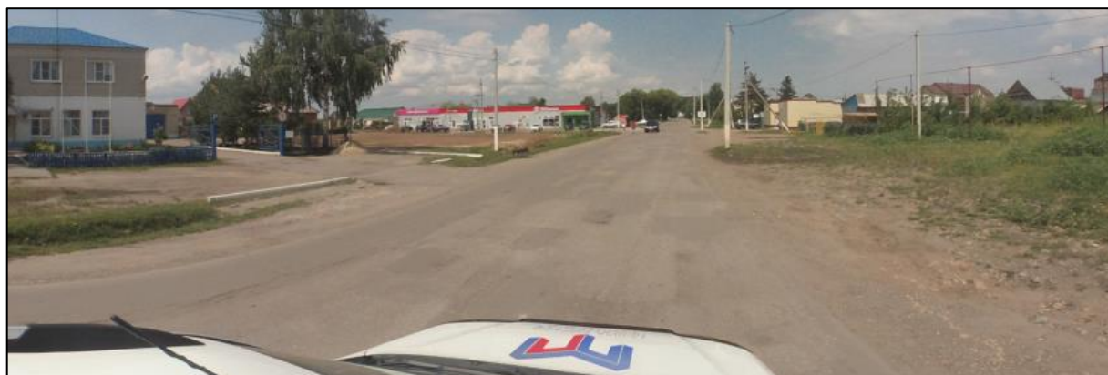
Рисунок 1.3.2– Состояние дорожного покрытия ул. Советская, р.п. Екатериновка на момент обследования
