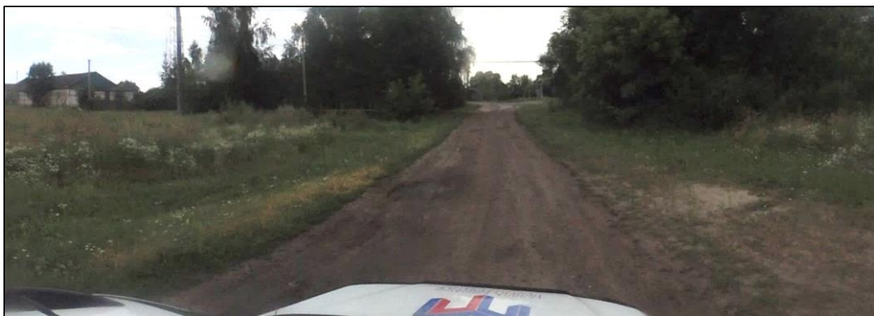
Рисунок 1.3.18 – Состояние дорожного покрытия ул. Верхняя, с. Воронцовка на момент обследования
