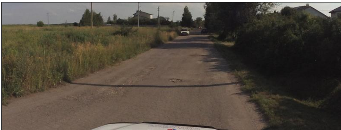
Рисунок 1.3.23 – Состояние дорожного покрытия ул. Центральная, д. Малая Екатериновка на момент обследования
