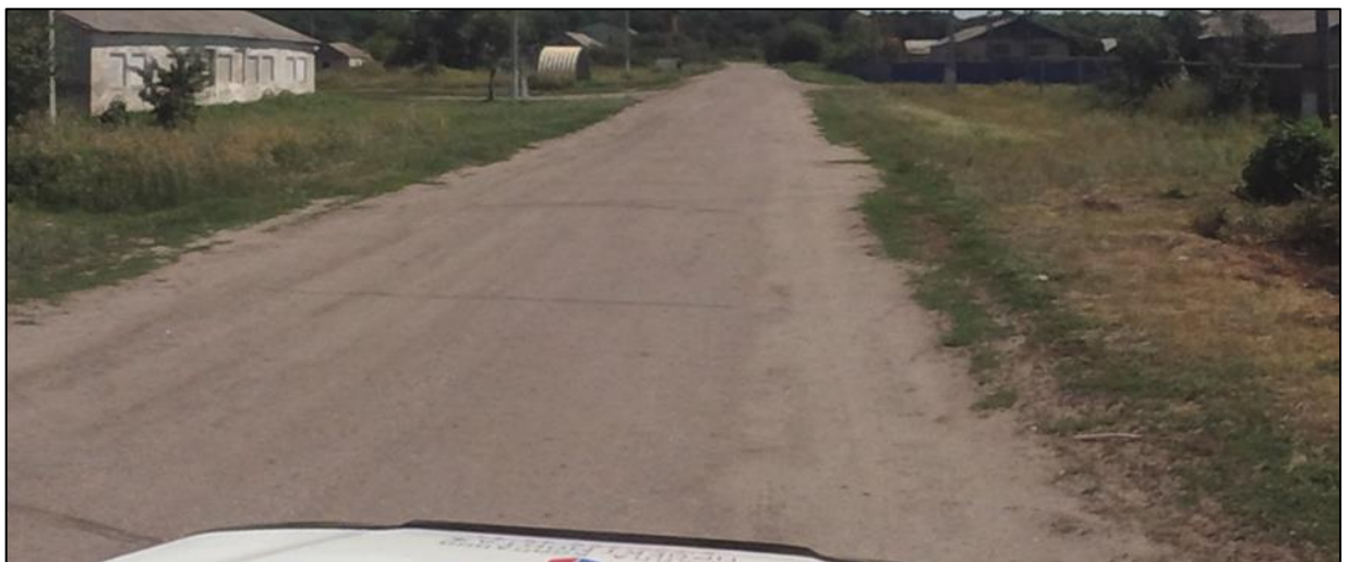
Рисунок 1.3.20 – Состояние дорожного покрытия ул. Юбилейная, п. Юбилейный на момент обследования
