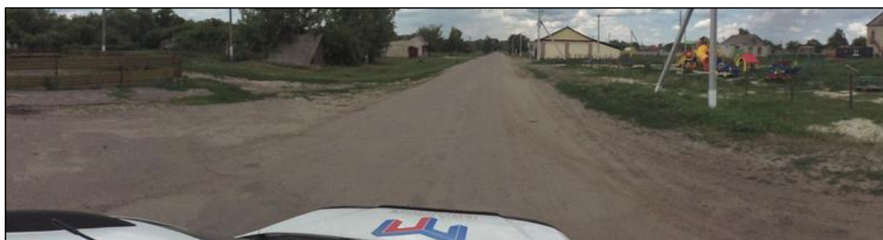
Рисунок 1.3.14 – Состояние дорожного покрытия ул. Революционная, с. Альшанка на момент обследования
