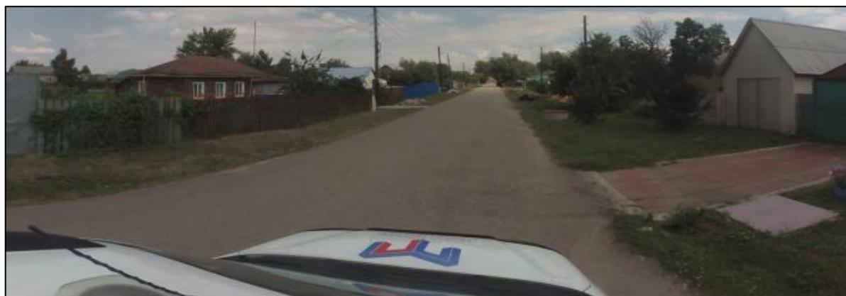
Рисунок 1.3.5 – Состояние дорожного покрытия ул. Рабочая, р.п. Екатериновка на момент обследования
