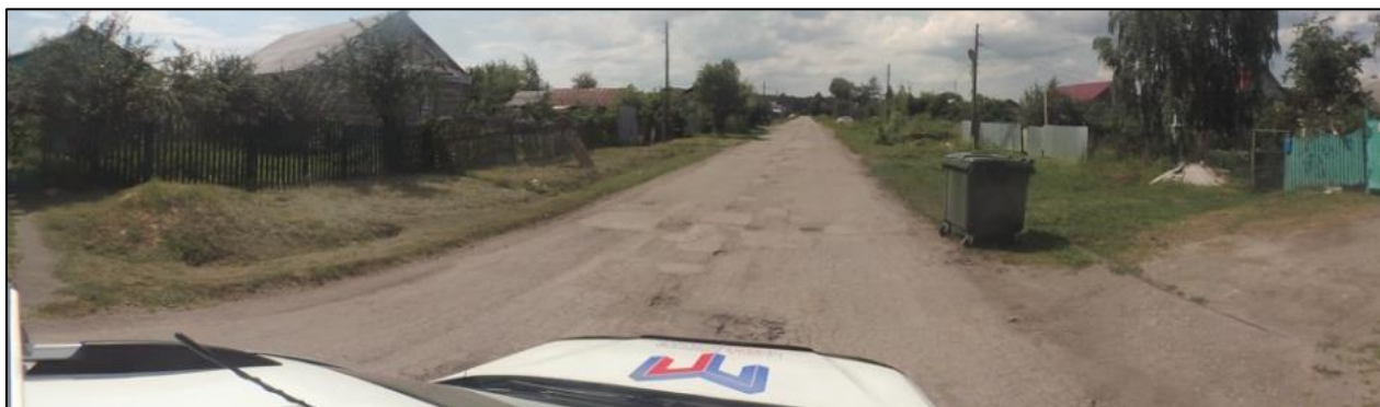
Рисунок 1.3.8 – Состояние дорожного покрытия ул. Ленинская, р.п. Екатериновка на момент обследования
