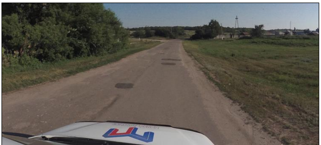
Рисунок 1.3.32 – Состояние дорожного покрытия ул. Рабочая, с. Сластуха на момент обследования
