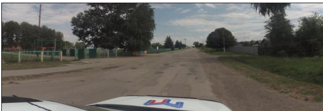
Рисунок 1.3.4– Состояние дорожного покрытия ул. 50 лет Октября, р.п. Екатериновка на момент обследования
