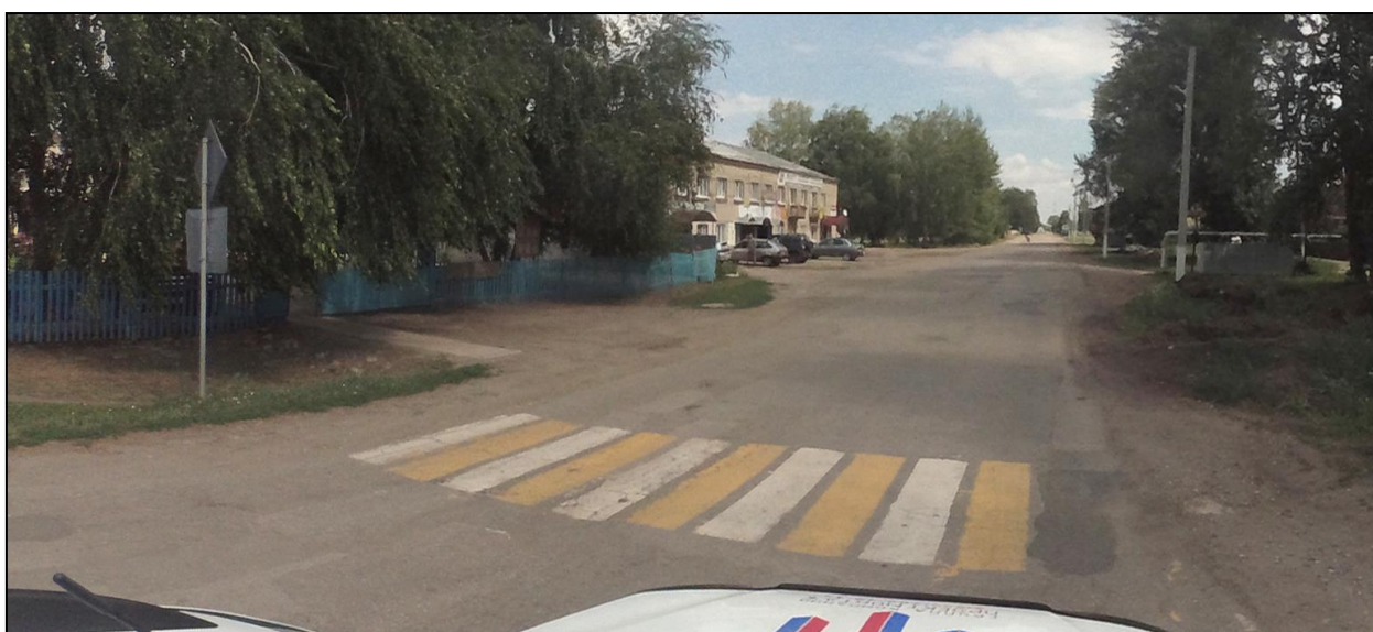
Рисунок 1.6.1 – Пример эксплуатационного состояния разметки 1.14.1 с жёлтым заполнением (обозначающей пешеходный переход), нанесённых по ул. 50 лет Октября, р.п. Екатериновка
