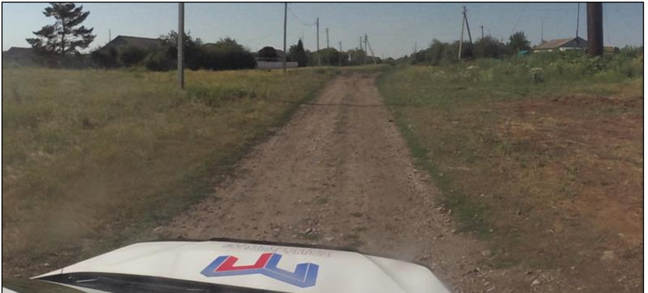
Рисунок 1.3.19 – Состояние дорожного покрытия ул. Садовая, с. Ивановка на момент обследования
