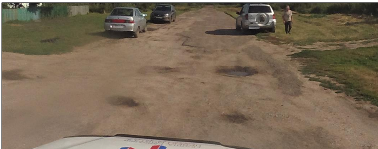
Рисунок 1.3.13 – Состояние дорожного покрытия ул. Ленинская, д. Упоровка на момент обследования
