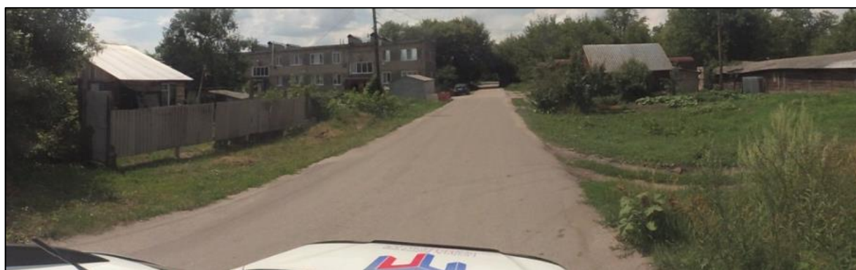
Рисунок 1.3.6 – Состояние дорожного покрытия ул. Вокзальная, р.п. Екатериновка на момент обследования
