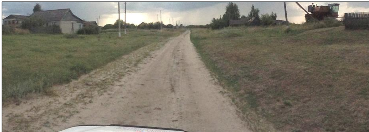
Рисунок 1.3.17 – Состояние дорожного покрытия ул. Кооперативная, с. Бутурлинка на момент обследования
