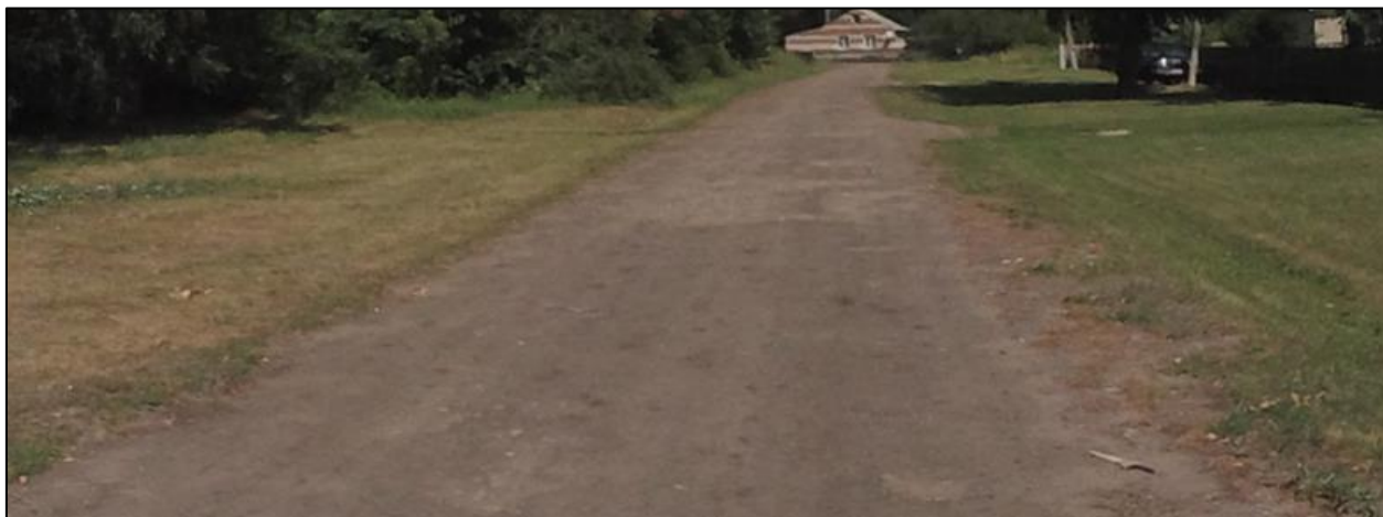
Рисунок 1.3.29 – Состояние дорожного покрытия ул. Школьная, с. Вязовка на момент обследования
